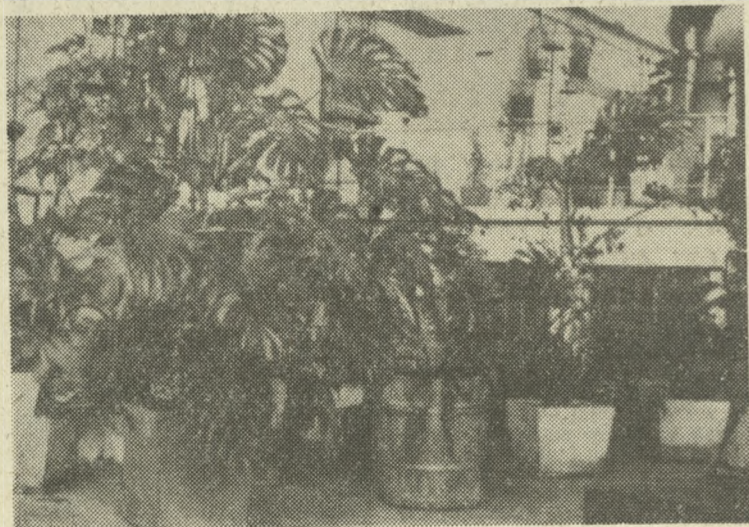
Niecodzienny widok przedstawiają okazale filodendrony w pomieszczeniu kompresorowni.
