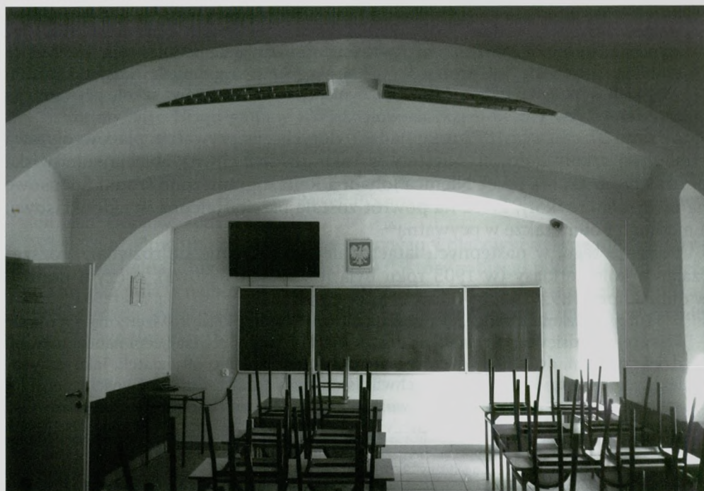
Sklepienia kolebkowe na gurtach występujące na parterze szkoły – sala lekcyjna Zespołu Szkół Zakładu Doskonalenia Zawodowego. Fot. Bożena Kubień, 24 kwietnia 2015 r.
