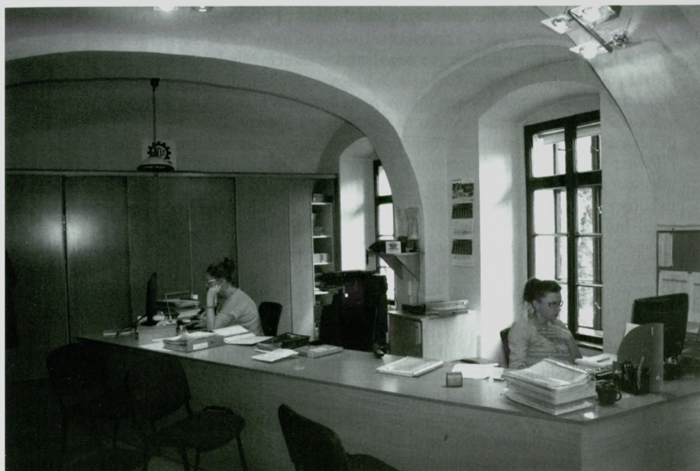
W części parterowej obiektu zachowały się sklepienia kolebkowe na gurtach oraz żaglaste – sekretariat Zespołu Szkół Zakładu Doskonalenia Zawodowego. Fot. Michał Pilch, 24 kwietnia 2015 r.
